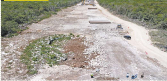
Meses después, gran parte del terreno está cubierto de cemento y una entrada desapareció.
